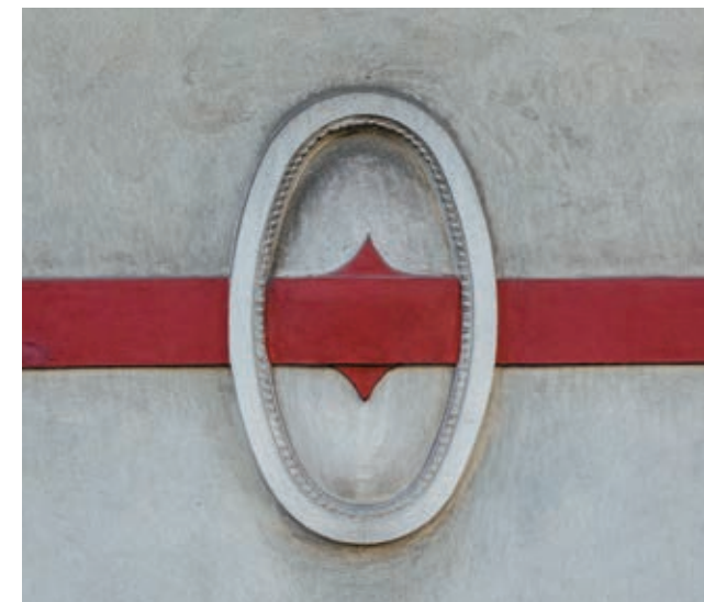
Детаљи фасаде Задужбине Влајка Каленића Details of the facade of the Vlajko Kalenić Endowment
